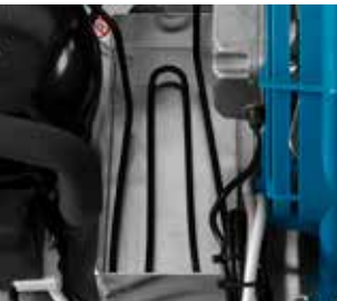
Evaporazione a costo zero L'acqua prodotta dagli sbrinatori evapora sfruttando il calore dissipato dal sistema refrigerante.
